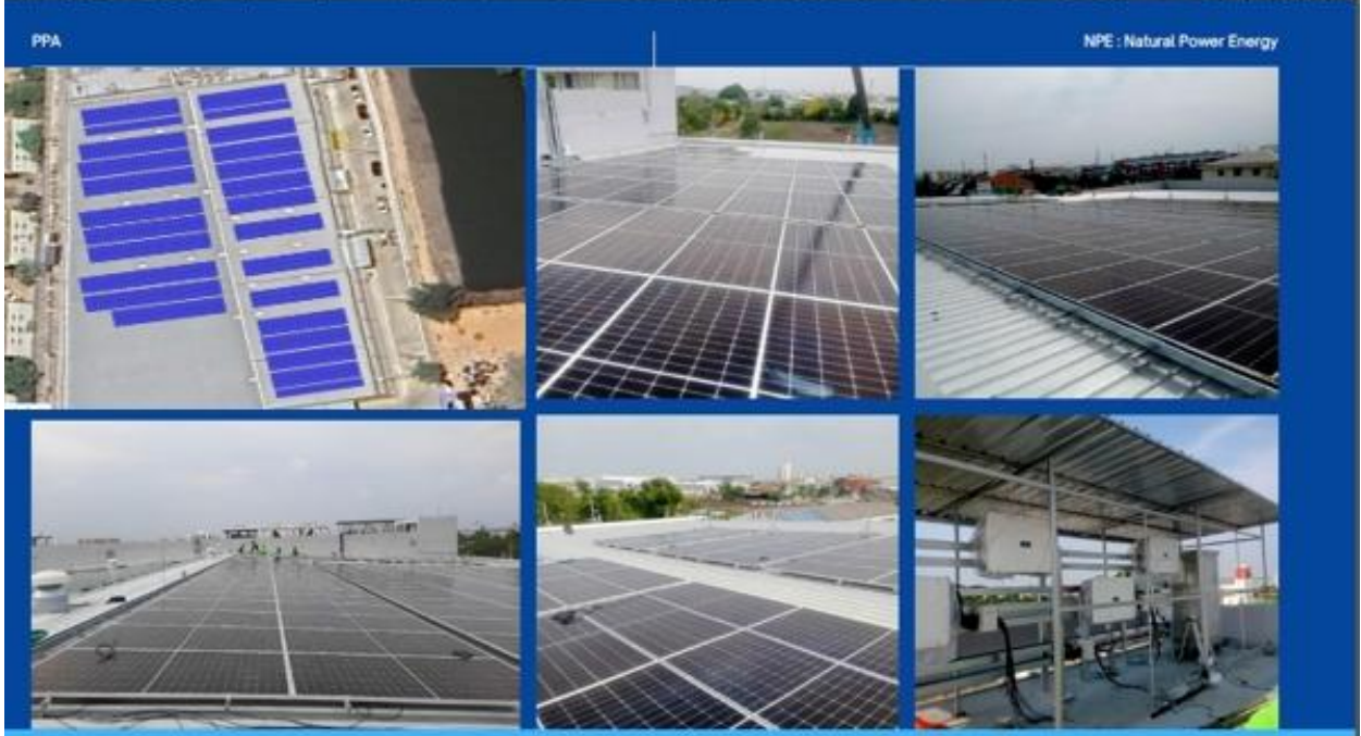
ติดตั้งแผงโซลาร์บนหลังคา (Solar roof) ของโรงงานแห่งใหม่ของบริษัท ฮินซิจี (ประเทศไทย) จำกัด (มหาชน) (HST)
